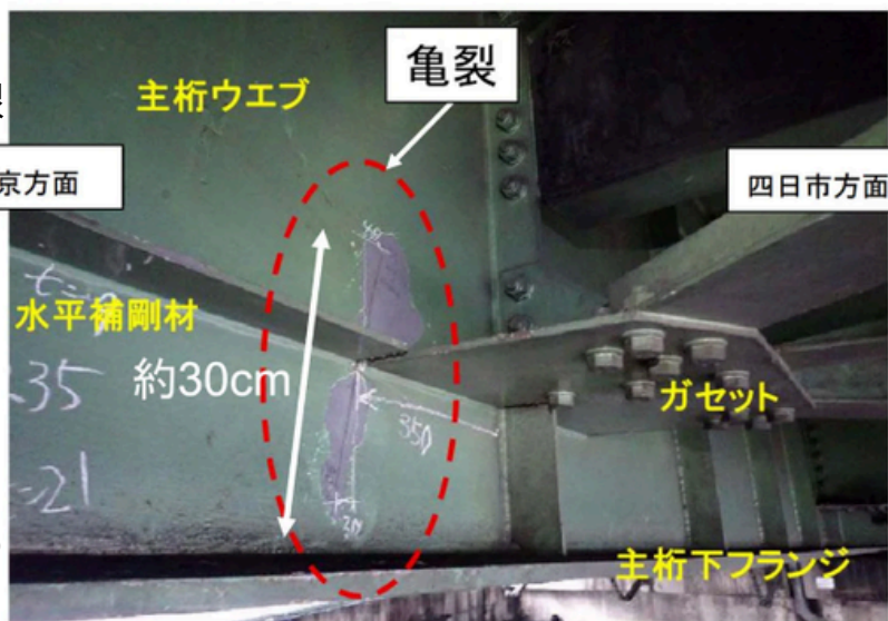
異常状況写真
