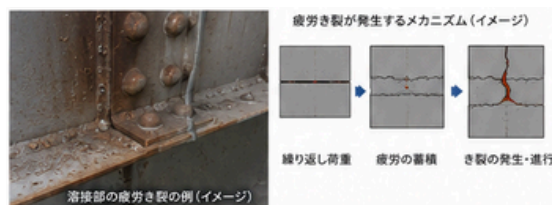
▲亀裂のメカニズム ※ 写真出典：国土交通省 中部地方整備局
